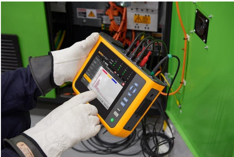
Analizador de energía y de calidad eléctrica Fluke 1777 en uso. Uno de los tipos de herramienta necesarios para la solución de problemas de calidad eléctrica son los analizadores de calidad eléctrica
