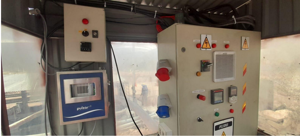
Figura 2. Instalación en campo del panel del instrumento
